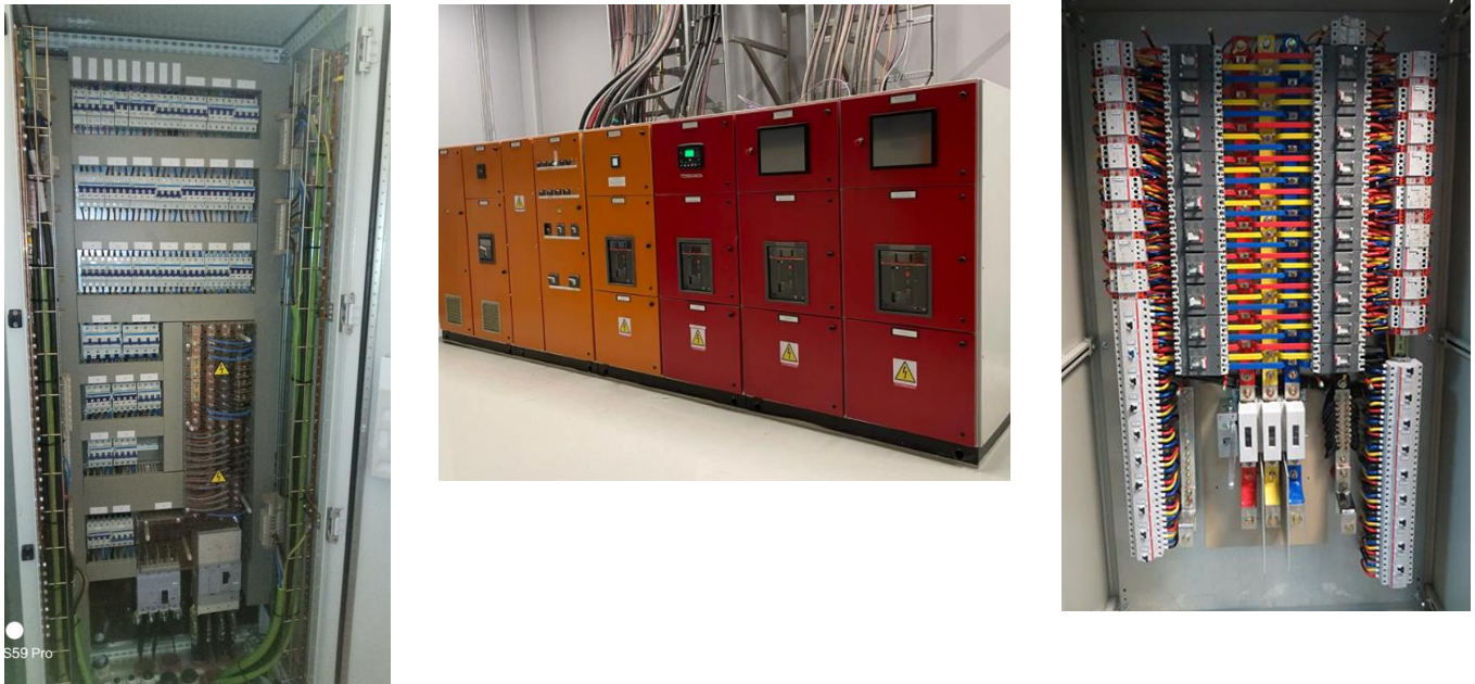
Figure 4 : Exemples de cabinets électriques bien conçus dans le cadre du travail de BHI
